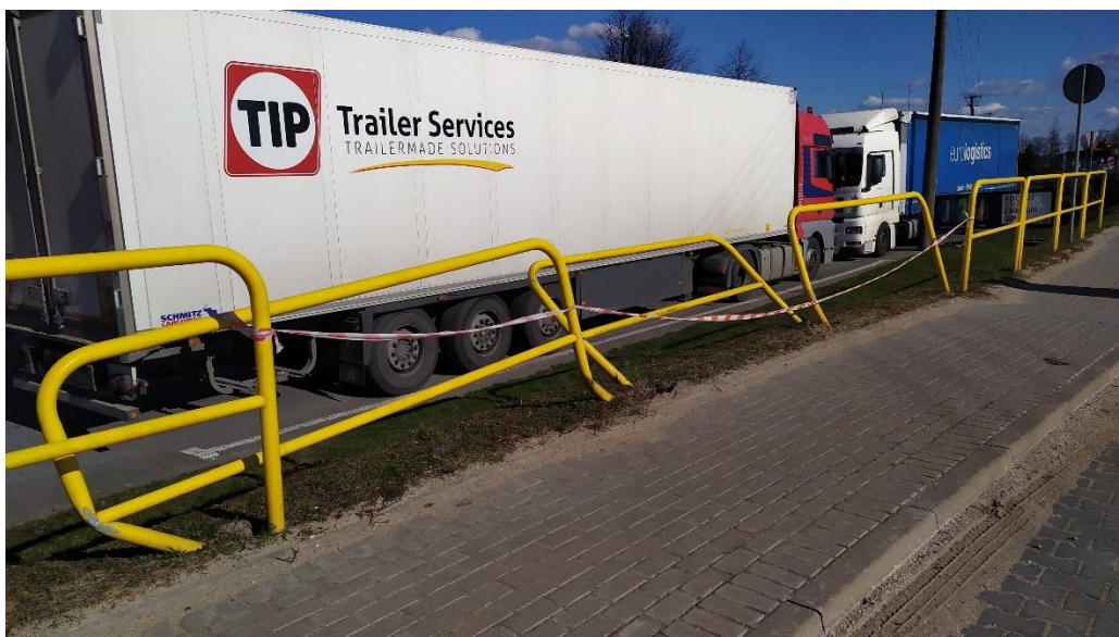
Fot. B.Bluma - Uszkodzone barierki ochronne na ul. Tucholskiej
